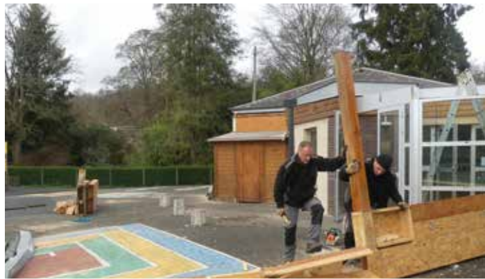
7 janvier - Ecole maternelle - Début des travaux préliminaires par les agents du service technique
